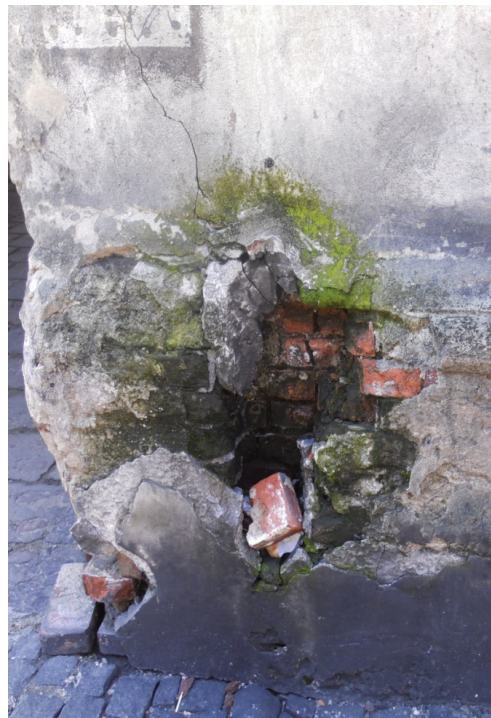
Zdjęcie nr 50 Uszkodzenia na elewacji AB
