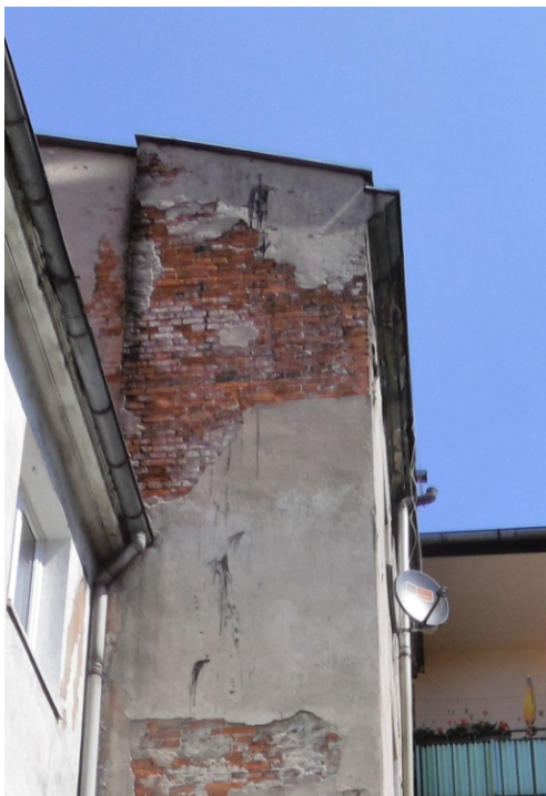
Zdjęcie nr 57 Uszkodzenia na elewacji CD
