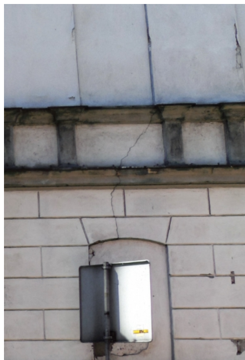
Zdjęcie nr 48 Rysy na elewacji AB
